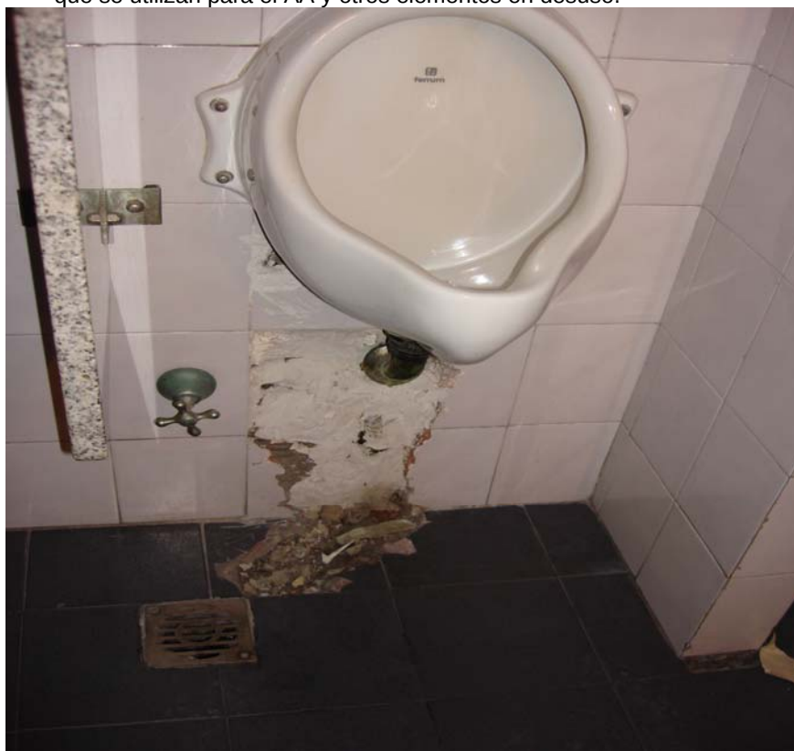
Foto N ° 22 Vista en el baño de varones del 7º piso un arreglo efectuado bajo un mingitorio por un pérdida de agua donde se rompió la pared y el solado y no se hizo la reparación de los mismos.
