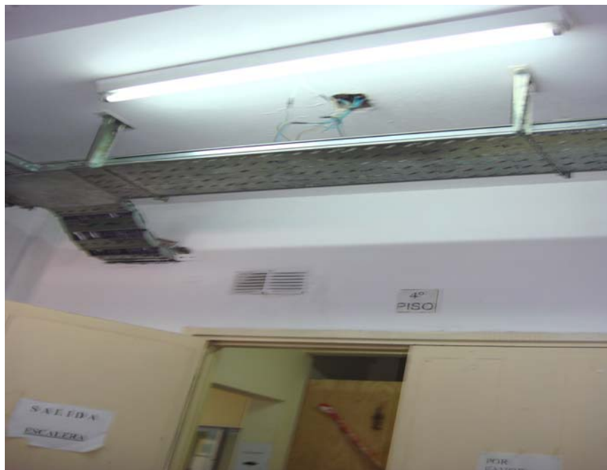
Foto N° 7 Vista del pasillo del 4° piso donde se pueden observar sobre la bandeja portacables cerca del cielorraso varios cables de electricidad expuestos y encintados que salen de un centro y alimentan un artefacto con un tubo de iluminación fluorescente.
