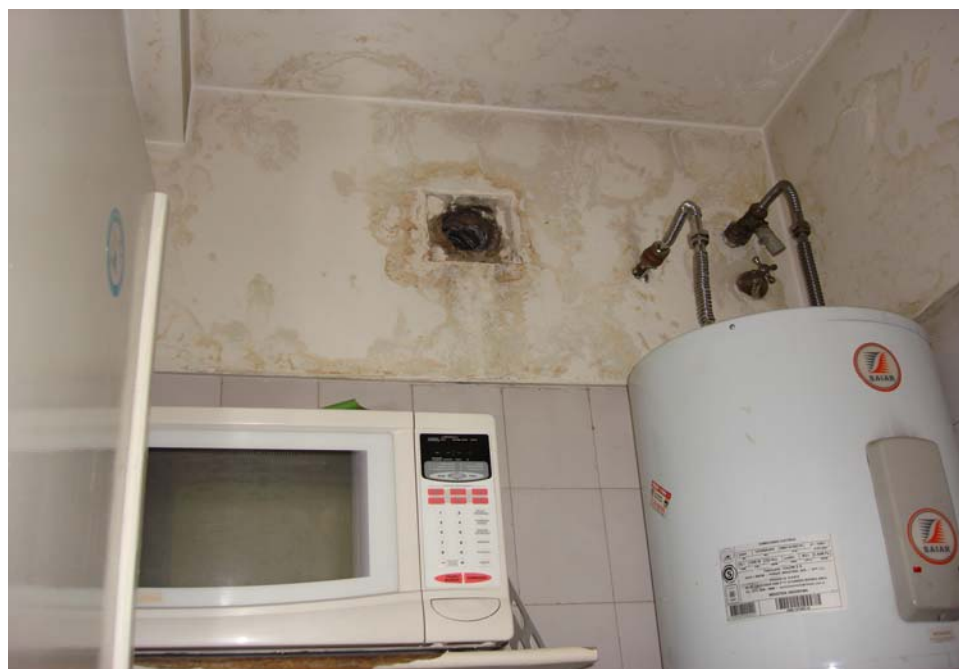
Foto N ° 20 Vista en el 7º piso en un office marcas de humedad en las paredes y el cielorraso y en la pared del frente una boca de electricidad con los cables expuestos y encintados. El termotanque que aparece a la izquierda no presenta caño de salida para los gases de combustión al exterior.
