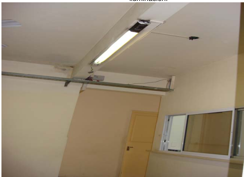
Foto N° 10 Observamos en el cielo raso de la presente vista un porta cables del que salen conductores expuestos y encintados que alimentan un aparato de iluminación con dos tubos fluorescentes y luego siguen penetrando en la pared. También vemos un centro de electricidad con los cables expuestos y encintados. En este sector se ven huellas de humedad en el cielo raso y en la pared.
