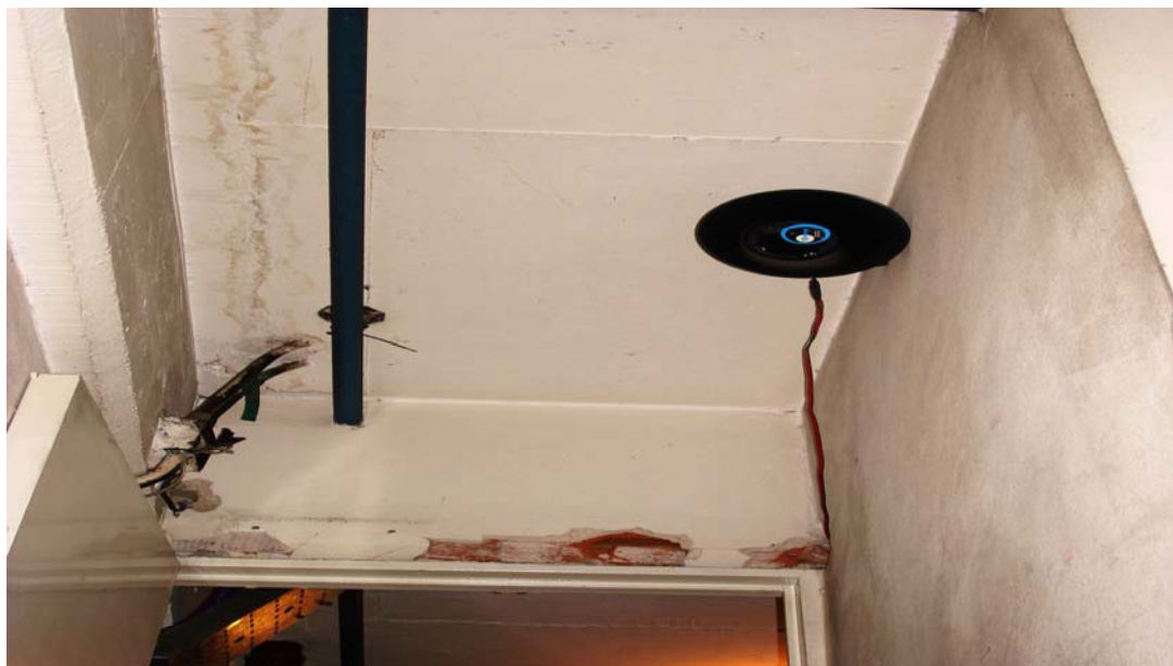
Foto N ° 11 Vista en la entrada al sótano, donde se puede ver sobre el marco de la puerta desprendimientos de material y en el techo un artefacto alimentado por un cable expuesto que sube junto al marco de la puerta.
