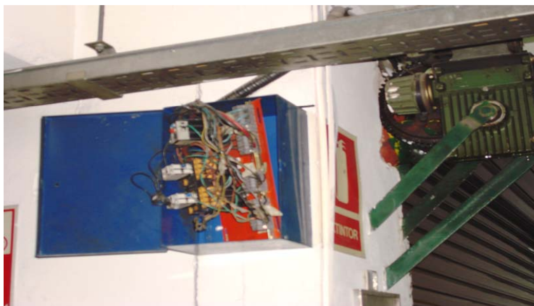
Foto N ° 8 Vista del tablero de electricidad que opera el montautos, se puede ver que el mismo presenta gran desorden con los cables de electricidad expuestos y la contratapa torcida lo que no permite accionar las llaves de corte correctamente. A la derecha se puede observar una chapa soporte reglamentaria sin el matafuegos correspondiente encima.
