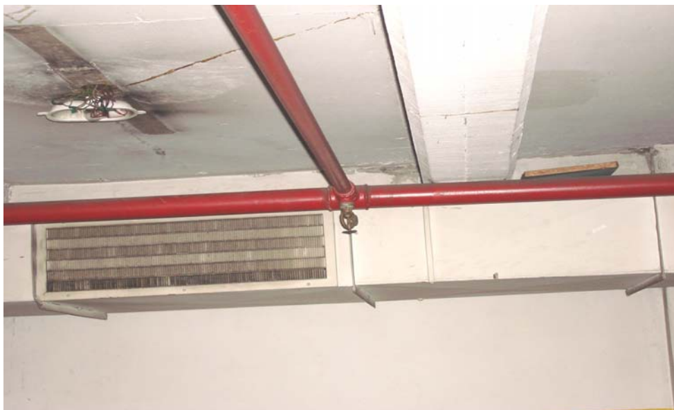
Foto N° 13 Vista en el sótano junto caños del sistema contra incendio del que salen los sprinklers o rociadores (que no funcionan), conductos de AA y un centro de iluminación con cables de electricidad expuestos y encintados.
