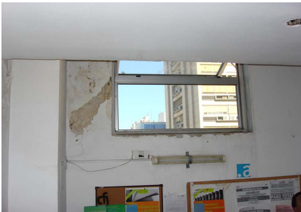
Foto N ° 6 Vista en el descanso de la escalera del 4° piso donde se pueden observar rastros de humedad en la pared junto al cielorraso mas abajo una luz de emergencia y en el cielorraso armado un centro de electricidad sin el artefacto de iluminación y con los cables expuestos.
