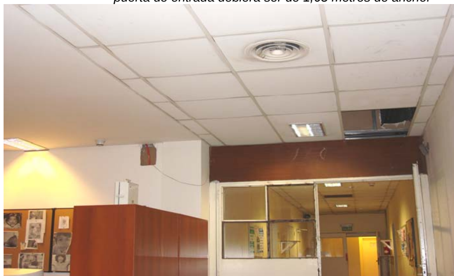
Foto N ° 2 Vista de un sector de 1° piso donde se pueden observar los arreglos que se están realizando en el techo donde falta un paño del cielorraso y a la izquierda sobre la pared del fondo de este salón un cable de electricidad expuesto que cuelga desde un caño de plástico flexible el que sale de una reparación efectuada en ese lugar y la que se encuentra sin la terminación debida.
