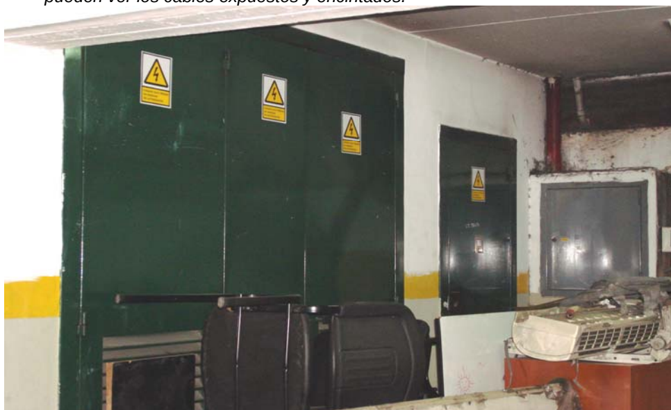
Foto N° 10 Vista de las puertas de los recintos donde están los transformadores de media tensión de electricidad general de la compañía. Estos transformadores tienen en la entrada 13200 volts de electricidad y bajan la corriente para consumo a los 220 volts de uso corriente. Es de notar que delante de las cabinas de estos transformadores se depositan materiales en desuso lo que en caso de una emergencia no permitiría actuar con rapidez sobre estos equipos.
