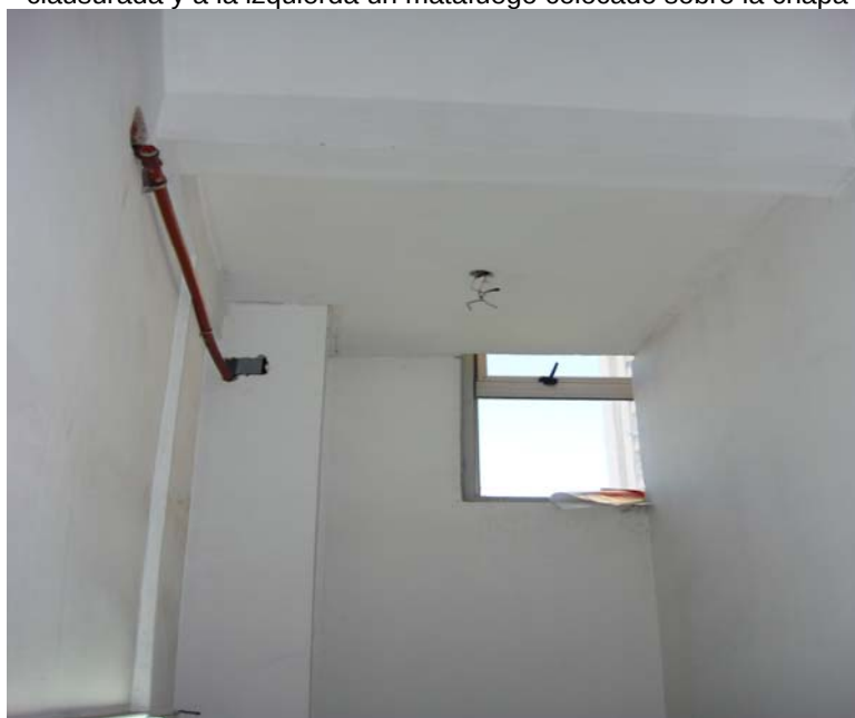
Foto N ° 4 Vista de la pared izquierda del descanso en la escalera del 3º piso se puede observar un caño de plástico del tipo “para gas” que sale de un sector y penetra en otro sin estar arreglados los orificios de la pared y en el cielorraso un centro del que salen dos cables de electricidad expuestos y encintados los que alimentarían a un artefacto de iluminación.
