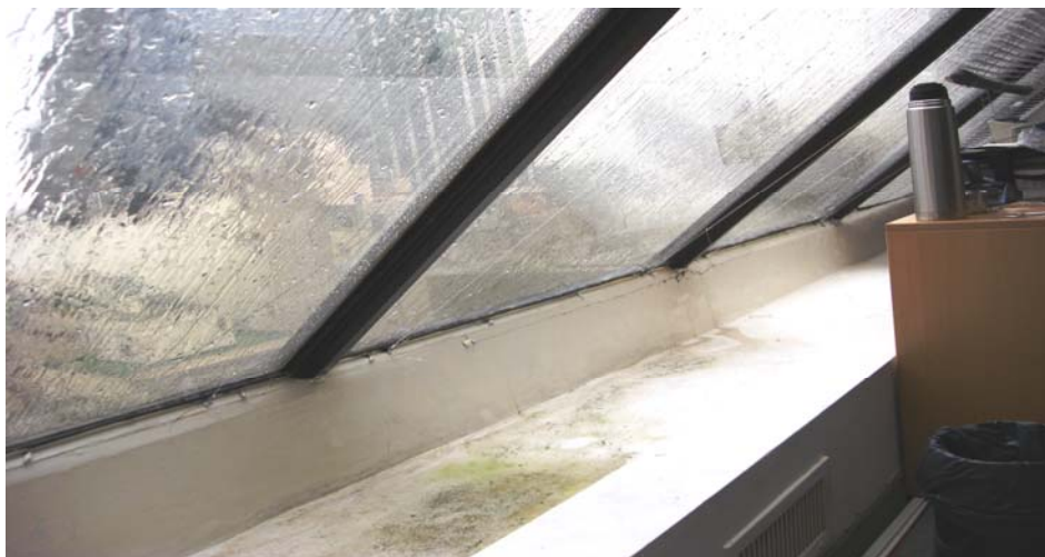
Foto N ° 5 Vista en una oficina del piso 13, la parte vidriada “en mansarda” presenta filtraciones en la unión de vidrios, este agua junto con la condensación que se produce escurren hacia la gran canaleta prevista para estos fines.
