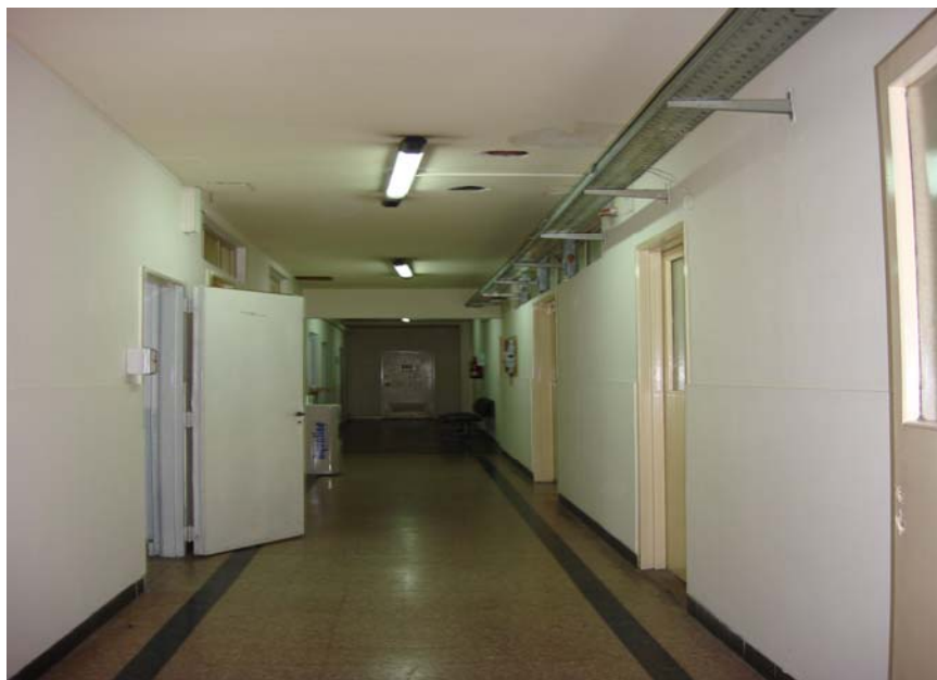
Foto N ° 11 Observamos en el pasillo del 3° piso en el cielorraso varias aberturas efectuadas para efectuar arreglos y no se volvieron a sellar y un porta cables del que salen dos cables expuestos que penetran en un centro en la pared.
