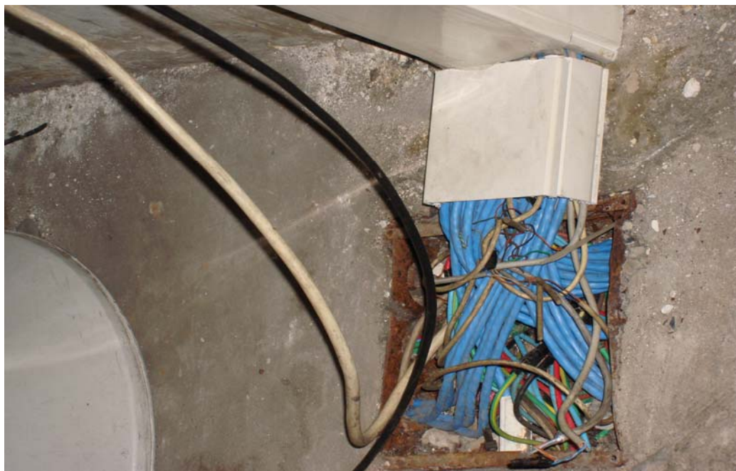
Foto N ° 19 Vista en el 7º piso una cámara de distribución de cables de sistema y algunos de electricidad expuestos en una zona con rastros de humedad en pared y cielorraso.
