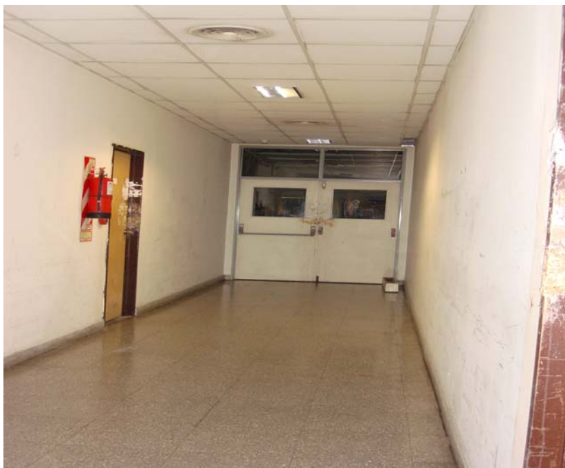
Foto N ° 3 Vista de un sector del pasillo del 1º piso donde se puede observar la puerta del fondo clausurada y a la izquierda un matafuego colocado sobre la chapa reglamentaria.
