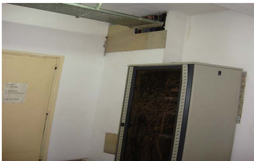
Foto N° 8 Vista en el 4° piso un rack de sistemas alimentado con cables desde un “pleno” al que le entran desde un porta cables cerca del cielorraso dejando la refacción de la entrada abierta sin terminaciones y en parte se encuentra cerrado con unas tablas de madera, alrededor del mismo hay huellas de humedad.
