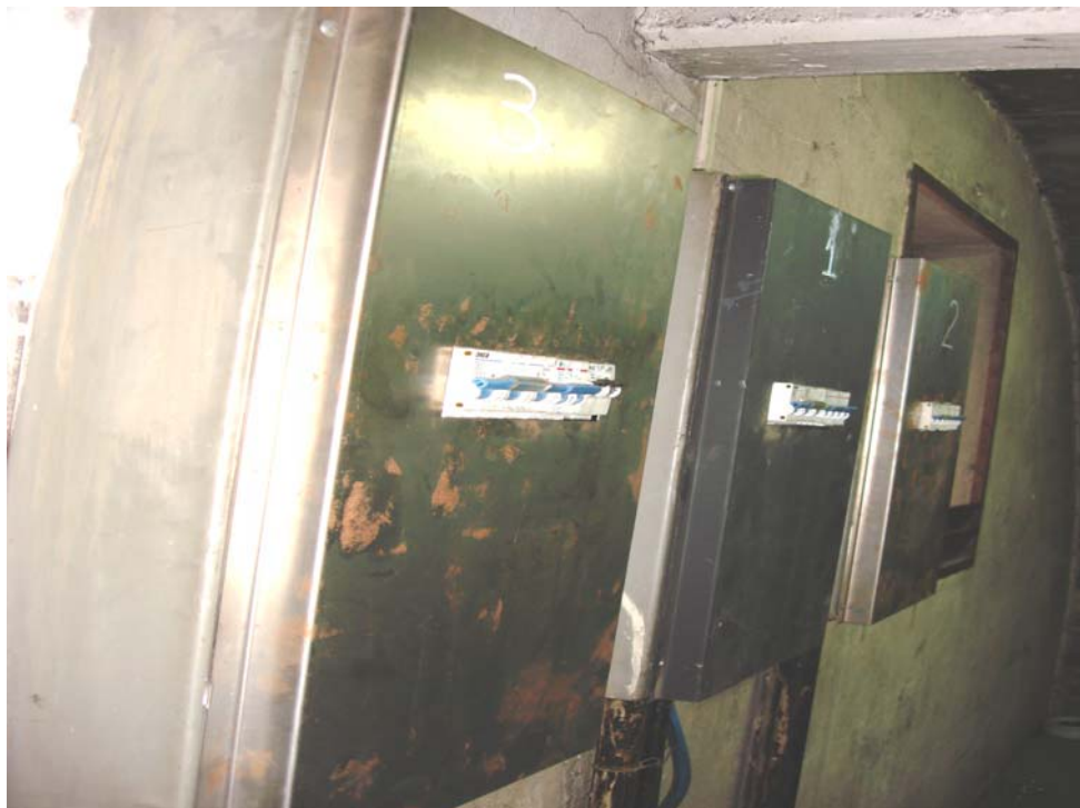
Foto N ° 4 Vista en la sala de ascensores los tableros de electricidad.
