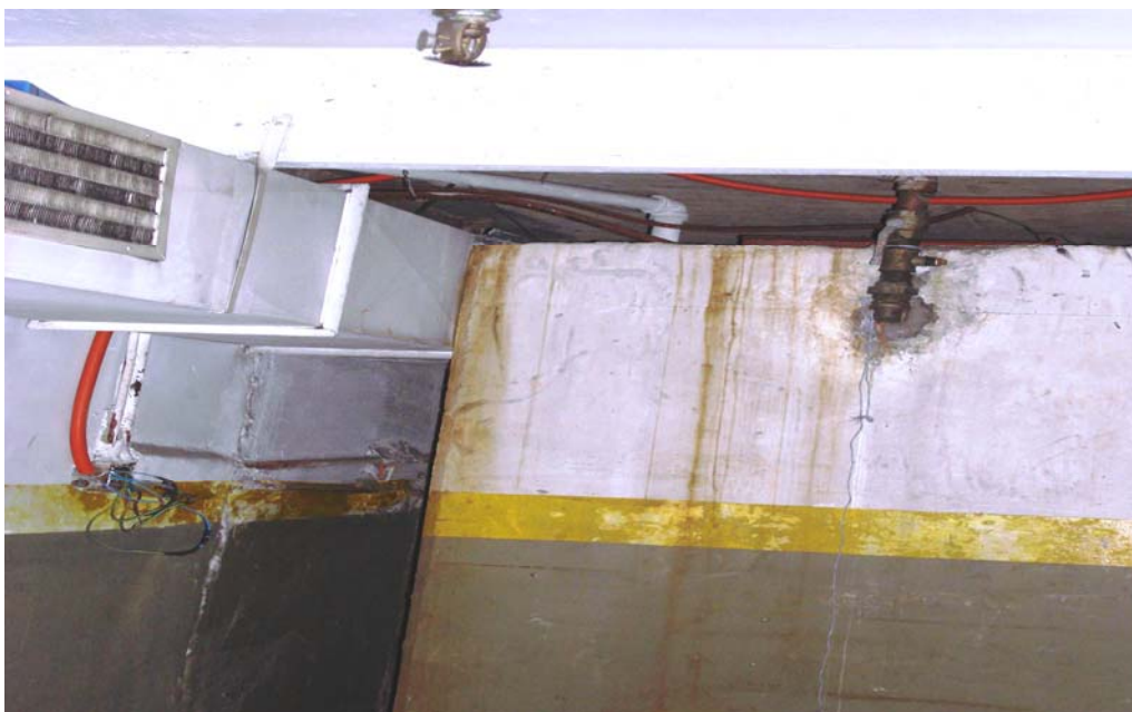
Foto N° 14 Vista en el sótano del tanque cisterna de bombeo, a la izquierda cables de electricidad expuestos y encintados salen de una caja de derivación eléctrica en una zona afectada por la humedad.
