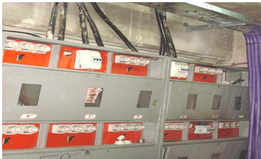
Foto N° 9 Vista del tablero de electricidad general con fusibles de cartucho, llaves de tecla y algunas llaves térmicas de corte trifásicas. Según la persona de mantenimiento se van a cambiar todas las llaves y fusibles a cartuchos antiguos por llaves térmicas. Es de notar que en el circuito N° 13 el contactor trifásico tiene los cables de los contactos expuestos, sobre el lugar donde están los cartuchos de los circuitos N° 5 y 7 se pueden observar las aberturas sin vidrio por donde se ven cables eléctricos expuestos y sobre el circuito 15 faltan los fusibles con la tapa de los mismos y se pueden ver los cables expuestos y encintados.
