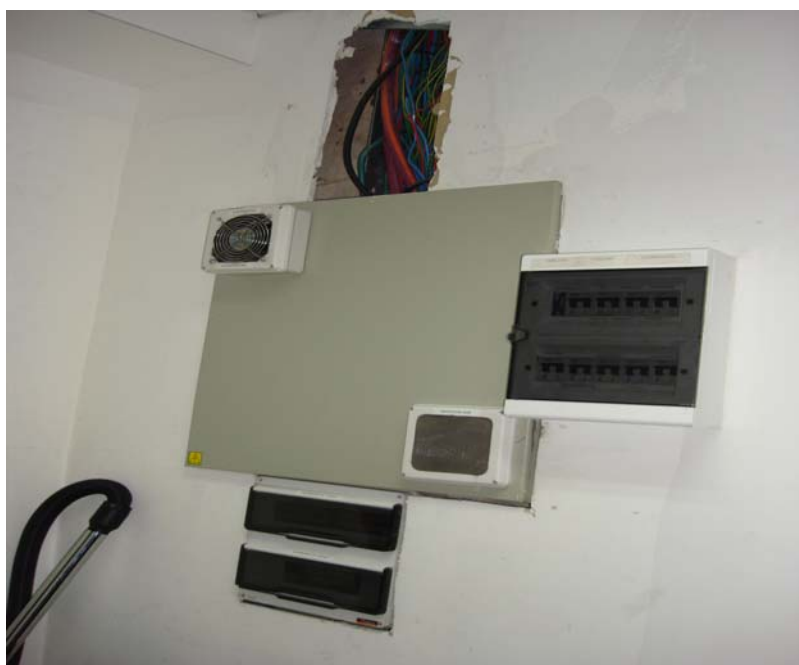
Foto N ° 14 Vista de un tablero de sistemas y a la derecha un tablero seccional de electricidad, en la parte superior hay cables de sistemas a la vista dentro de un “pleno” en la pared a medio cerrar con una tabla de madera.
