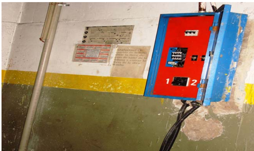
Foto N° 15 Vista en el sótano donde está el tanque de bombeo se puede apreciar el tablero de electricidad que opera las bombas con la contratapa pero en el lugar donde están las llaves de corte faltan las tapas y quedan los cables de electricidad expuestos.
