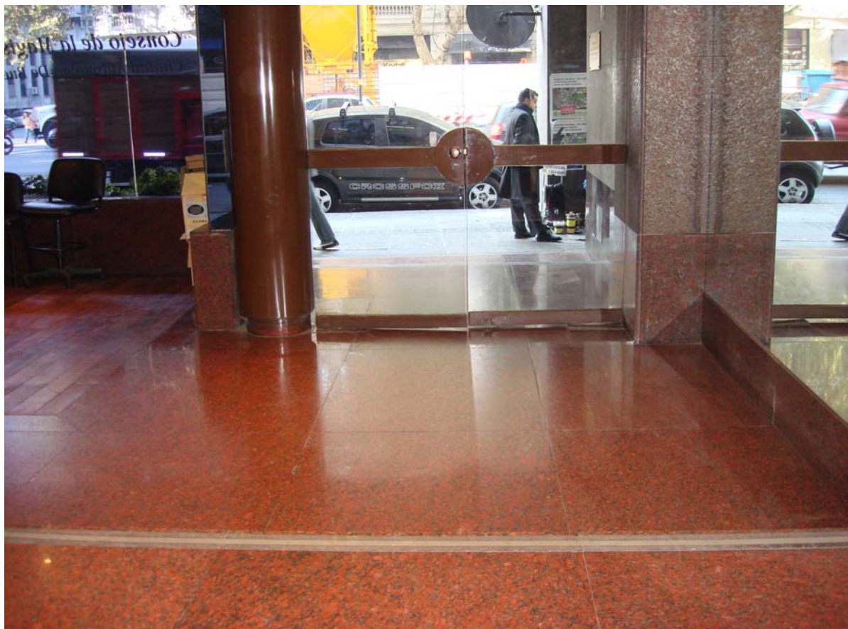
Foto N ° 23 Vista de la salida por 25 de mayo que según el intendente de este edificio sería la “salida de emergencia” pero a los fines de una emergencia no cumple pues abre hacia adentro y no tiene el manijón que corresponde a una salida anti-pánico para poder salir empujando la puerta. Es de notar que esta puerta tiene a la salida dos escalones que no incluyen rampa para discapacitados.
