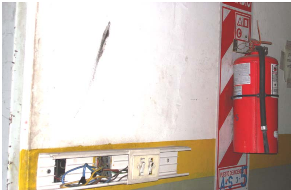
Foto N° 16 Vista en el sótano donde está el tanque de bombeo dos llaves de corte de electricidad colocadas en un riel de plástico y detrás salen varios cables de electricidad expuestos y encintados. A la derecha un matafuego del tipo ABC colocado en la pared sobre una chapa reglamentaria.
