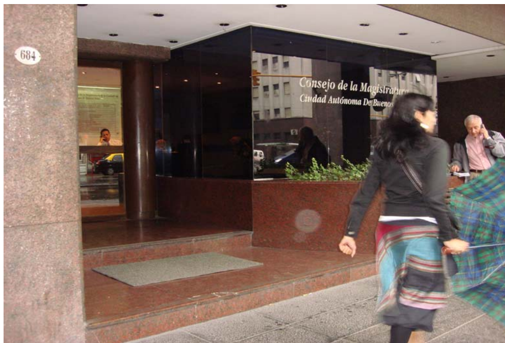
Foto N ° 1 Acceso al consejo de la magistratura, en la presente vista se puede observar que este edificio carece de rampas para discapacitados en la entrada al mismo.
