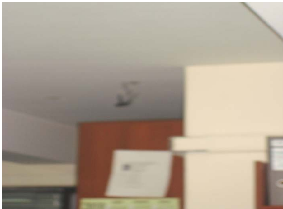
Foto N ° 17 _ Vista en el 7° piso de una boca de iluminación sin el artefacto y con los cables de electricidad expuestos y encintados.
