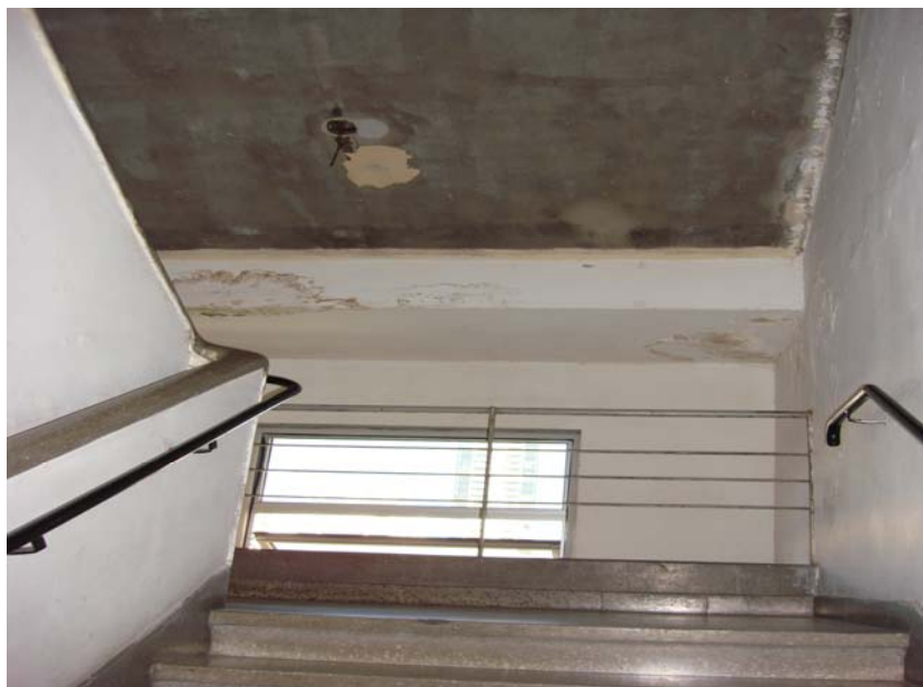
Foto N° 9 Vista del descanso de la escalera del 5° piso donde se puede observar en el cielorraso y en la pared huellas de humedad, así mismo hay en el techo un centro de electricidad con los cables de electricidad expuestos y encintados sin el artefacto de iluminación.
