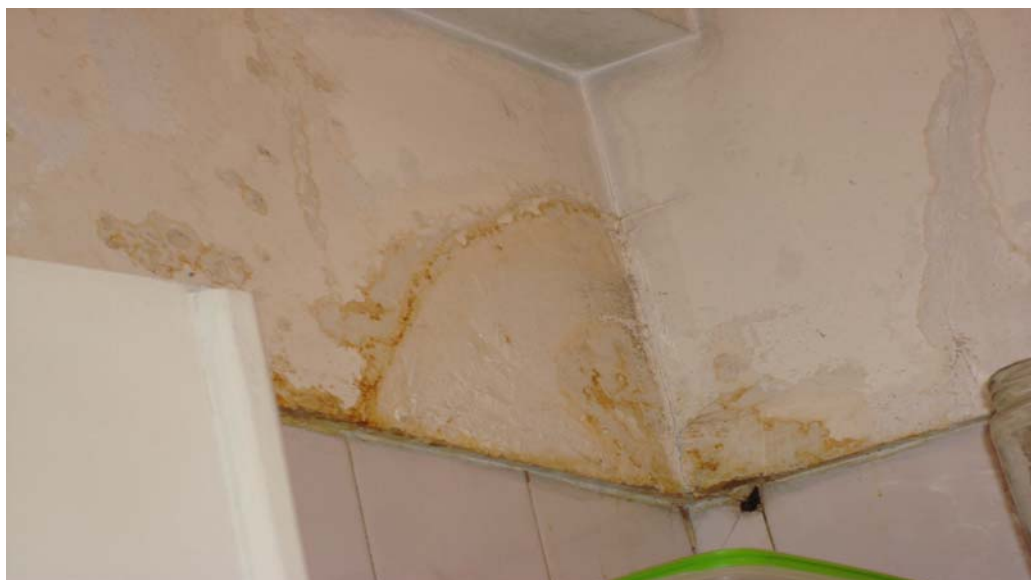
Foto N ° 18 Vista en el 7° piso en un office marcas de humedad de una filtración de agua en las paredes y el cielorraso.
